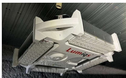
人感センサー付 LED照明の導入
