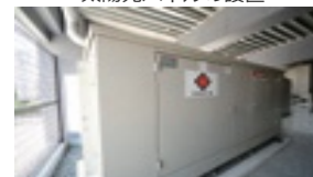
非常用発電設備の設置
