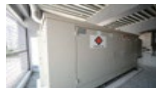
非常用発電設備の設置
