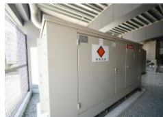
非常用発電機の設置
